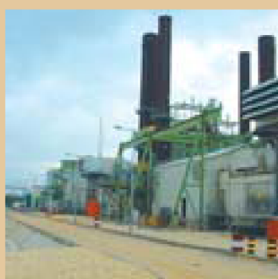
محطة كهرباء غزة
